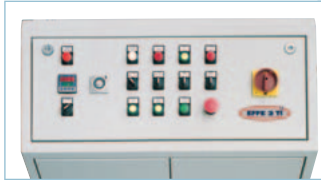
Quadro elettrico di gestione del forno
